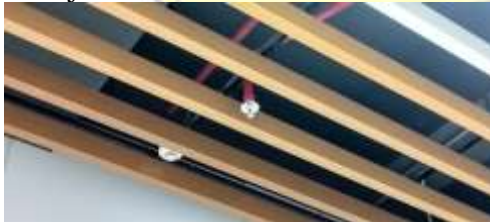
Gambar 9. Sistem Keamanan Kebakaran (Dokumen Pribadi).
